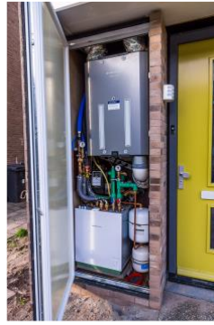
Kast aan de voordeur met warmtepomp en balansventilatie
