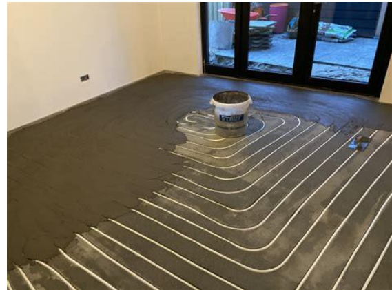
Vloerverwarming in cementdekvloer
